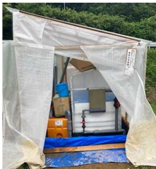
福島県飯舘村に設置した無加温メタン発酵装置
