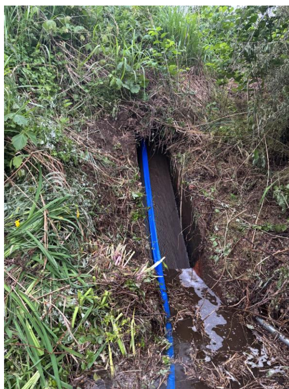
図2 急斜面のコンクリート水路の射流中で潰れて水が流れなくなったホース（6月3日）
